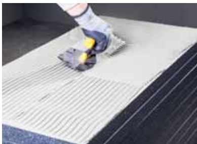
Снимка 1 Ако повърхността е плоска; адхезивната мазилка се нанася върху цялата топлоизолационна плоча с мистрия или подходяща назъбена мистрия, по метода на залепване на цялата повърхност.
