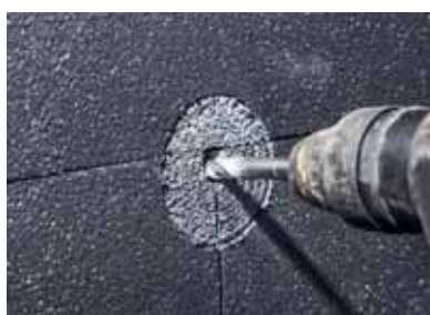
Снимка 2 Пробива се мястото на стенния плъгин. трябва да бъде 1 см по-голяма от големината на стенния плъгин.
